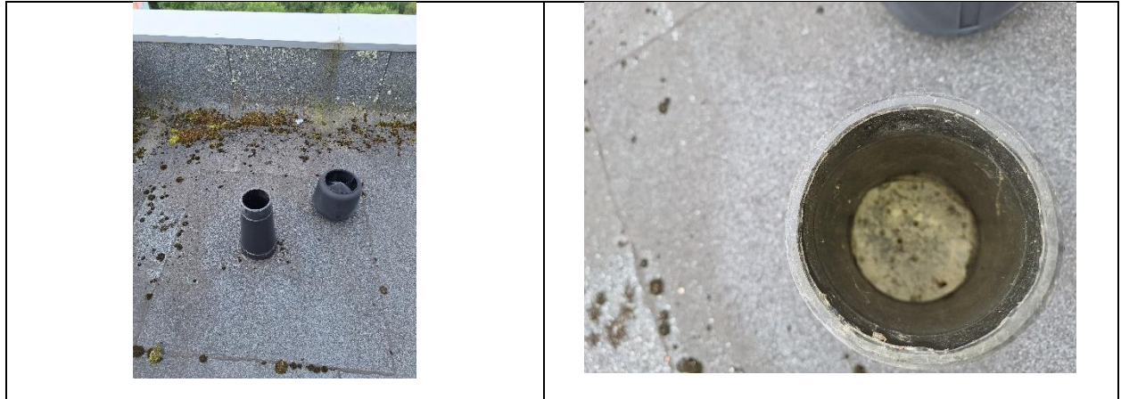
Foto 10; 11: Tuulutuskorstna katte äravõtmisel selgus, et katuslagi ei ole tuulutatud. Tuulutuskanalid ei sulge tuulutuskorstnasse, korsten on umbne. See selgus kõikide katuslae tuulutuskorstnate uuringul.
