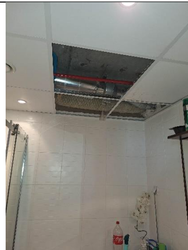
Foto 4: Ripplae avamisel selgus, et märja lae ruumis ei ole aurutõket, niiske aur tungib konstruktsioonidesse, sest vahelae paneelide vuugid on avatud.
