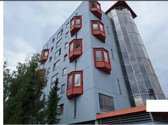
Foto 1: 9-korruselise korterelamu välisvaade, mille viiendal korrusel asub korter 21, kuhu vannitoa laest on vee läbijooks.
