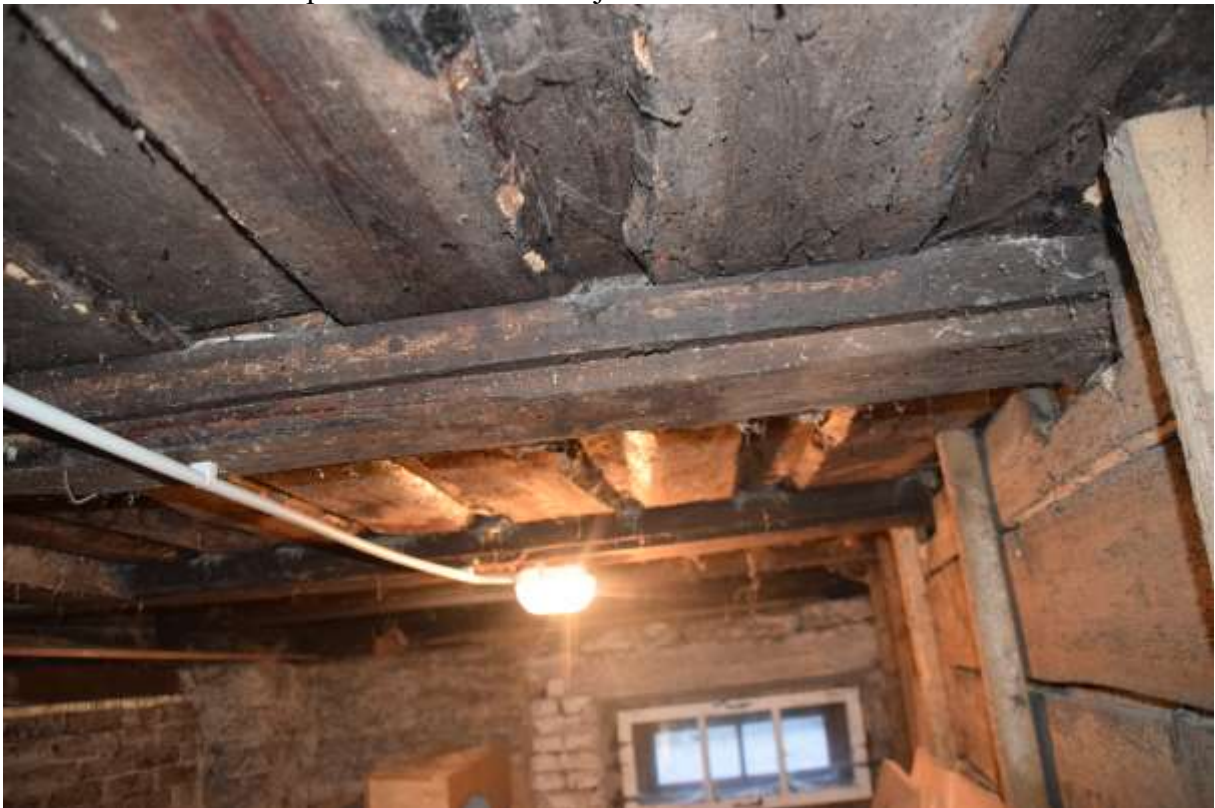
Foto 2. Kahjustatud laetald hoone keldri tänavapoolses osas
