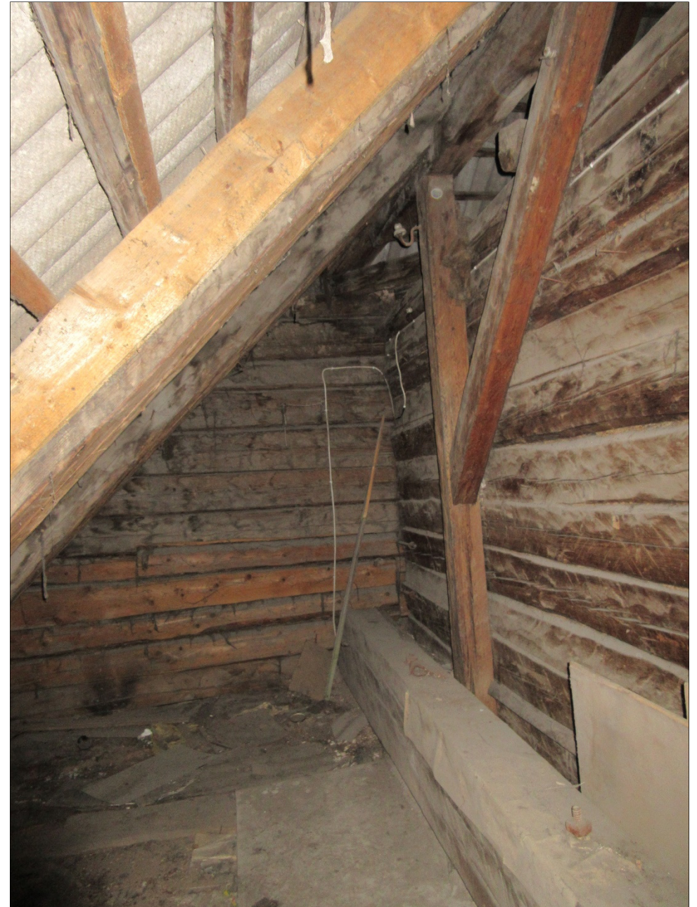
16. Säilinud algne toolvärk ja sarikad. Näha riputustala kahjustunud vahelael
