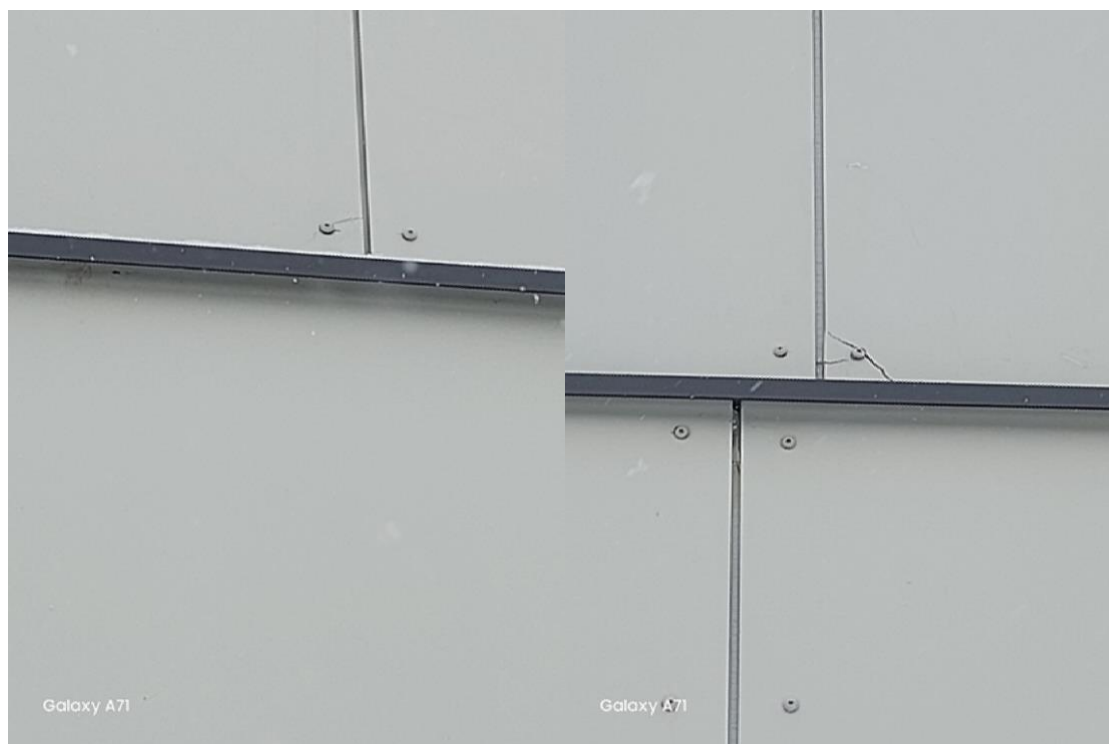
Foto nr 3 – sarnaselt eelmistele fotodel esinevad diagonaalsuunalised praod fassaadiplaatide kinnituskohtades. Fotod on tehtud tõenäoliselt hoone otstest. Allikas: Tellija esitatud foto, foto tegemise aeg on 05.04.2024.
