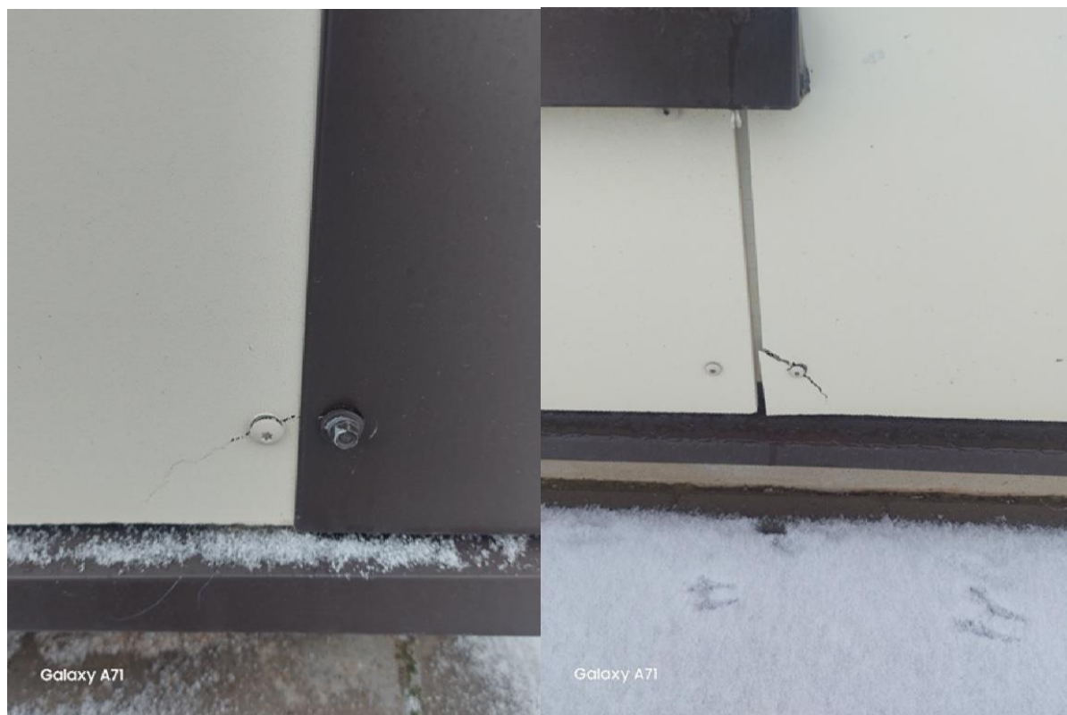
Foto nr 2 – diagonaalsed praod esinevad fassaadiplaatide kinnituskohtades. Fotod on tehtud sokli piirkonnas. Allikas: Tellija esitatud foto, foto tegemise aeg on 05.04.2024.
