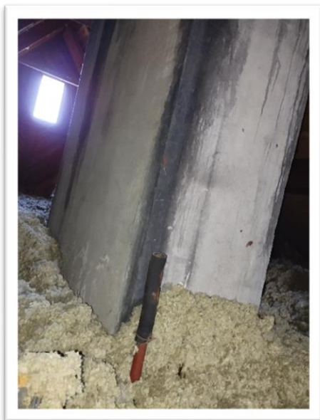
Puistevill vastu korstnat pööningul
