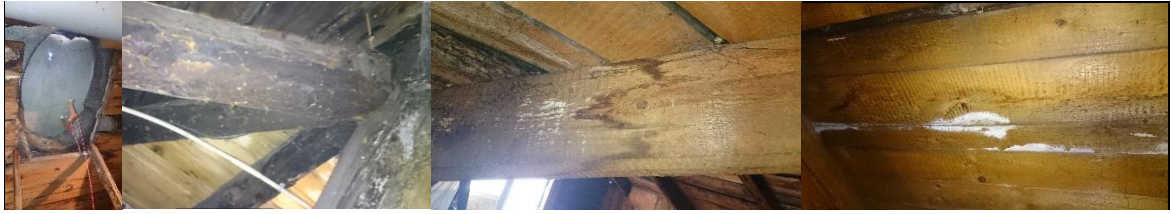
Foto 11, Foto 12, Foto 13 ja Foto 14. Katuse luugi, sarikate ja roovituse seisukord (autori erakogu)
