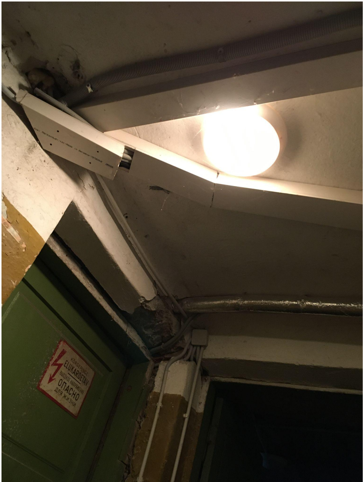
Näide ol.ol. elektrikaabeldusest ja veetorudest. Uksel olev silt on dekoratiivne, ukse taga on tavaline keldriboks.
