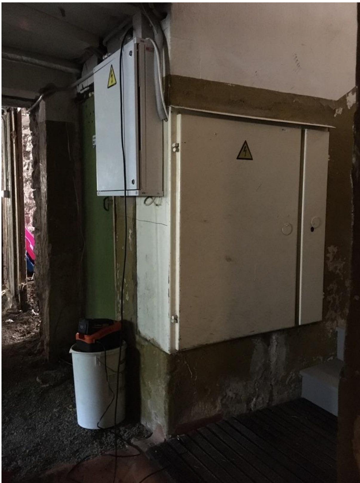
Paremal vana, põhimõtteliselt kasutuseta elektrikilp. Vasakul uus, kasutuses olev elektrikilp. Vasakpoolse kilbi taga (kõrval) paistab roheline veemõõdusõlme uks.
