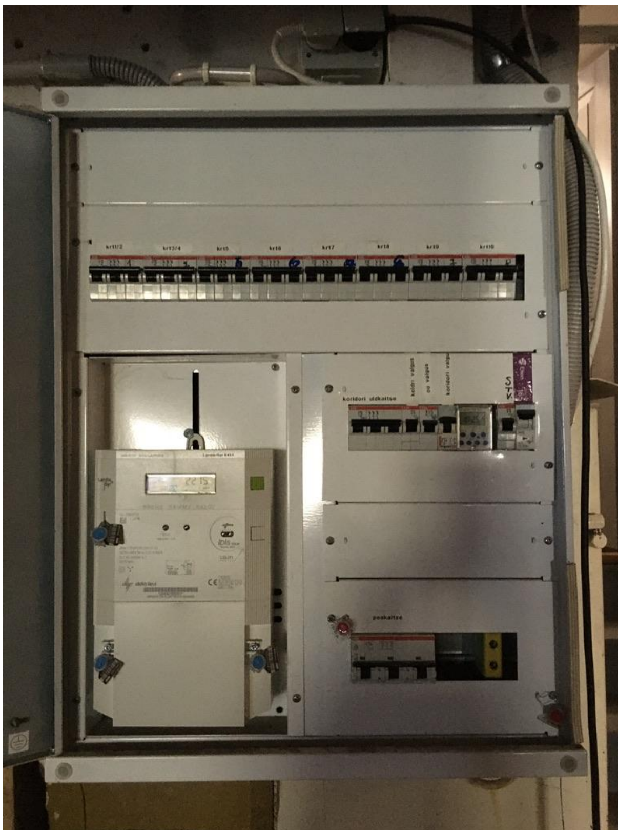
Kasutuses oleva elektrikilbi sisu. Foto 20.06.2021.
