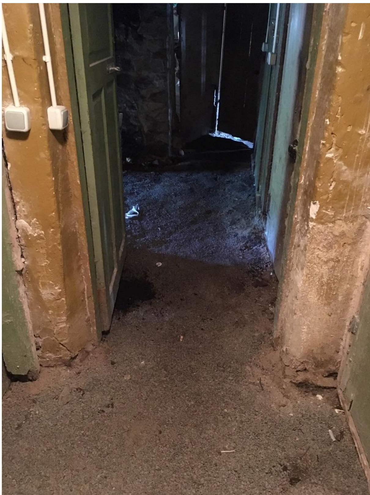
Vaade trepist paremale suunduvasse koridori. Koridoripõranda (killustiku) all on 2017-2018. aastal välja vahetatud kanalitorustik.
