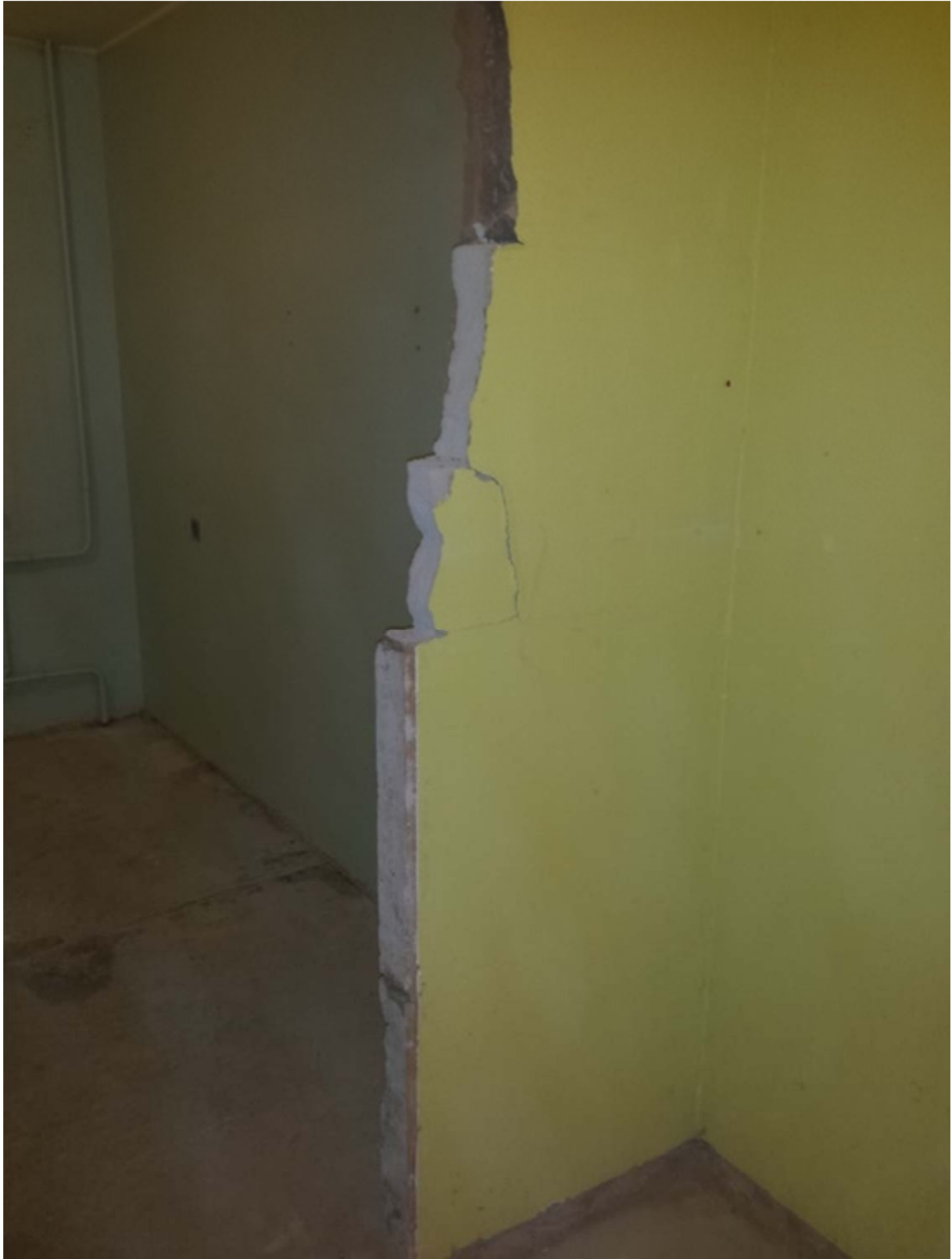
Lammutamist ja uuesti ehitamist vajav sisesein esikus
