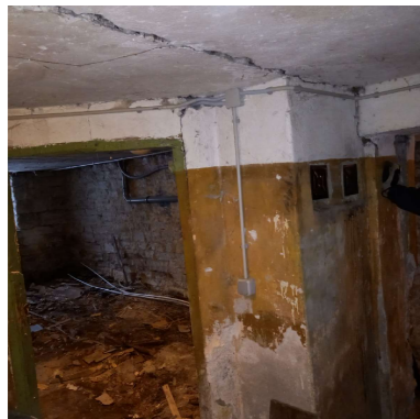
Foto nr.4 Korstna jalg on vajunud. Vundament vajab tugevdamist.
